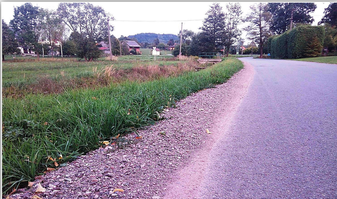
Opravy okrajů vozovek v obci (vyfoceno 26. 9. 2015, autor L. Šimek)
